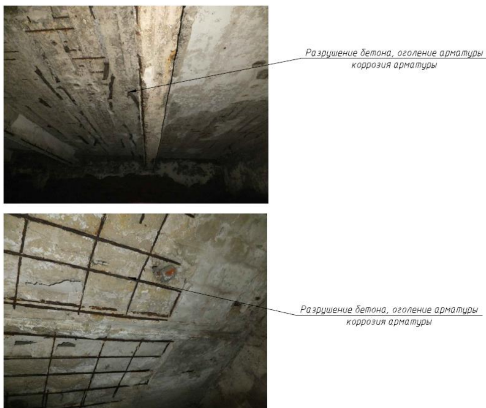
Рисунок 5.79 Примеры дефектов, устраняемые системой внешнего армирования CarbonWrap®
