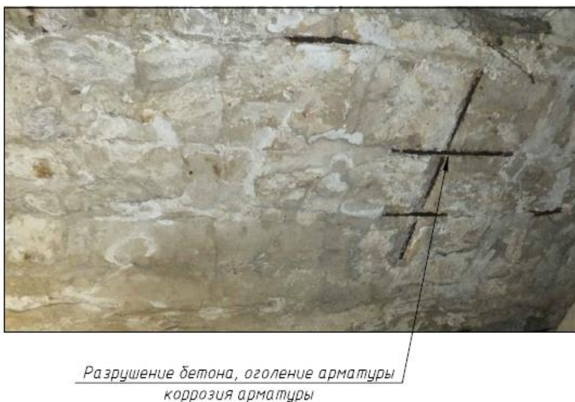
Рисунок 5.83 Примеры дефектов, устраняемые системой внешнего армирования CarbonWrap®
